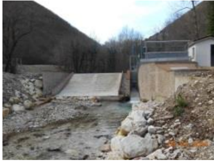
Nuova Centrale idroelettrica
